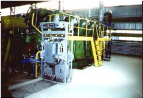
Fig. 1- Tablou local instalat pe un gazomotocompresor tip 10GKNA
