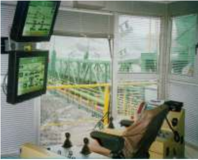
Fig.1 Cabina de comandă după modernizare
