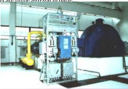
Fig. 2- Tablou local instalat pe un electrocompresor tip C260
